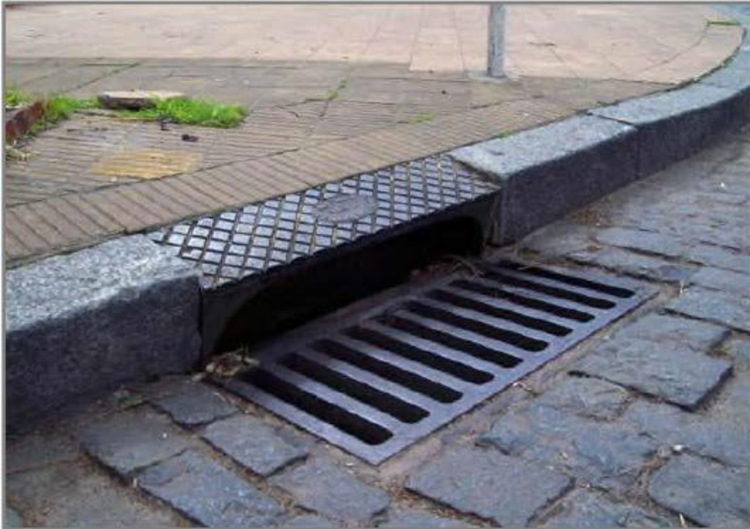
Bouche d'égout à avaloir
