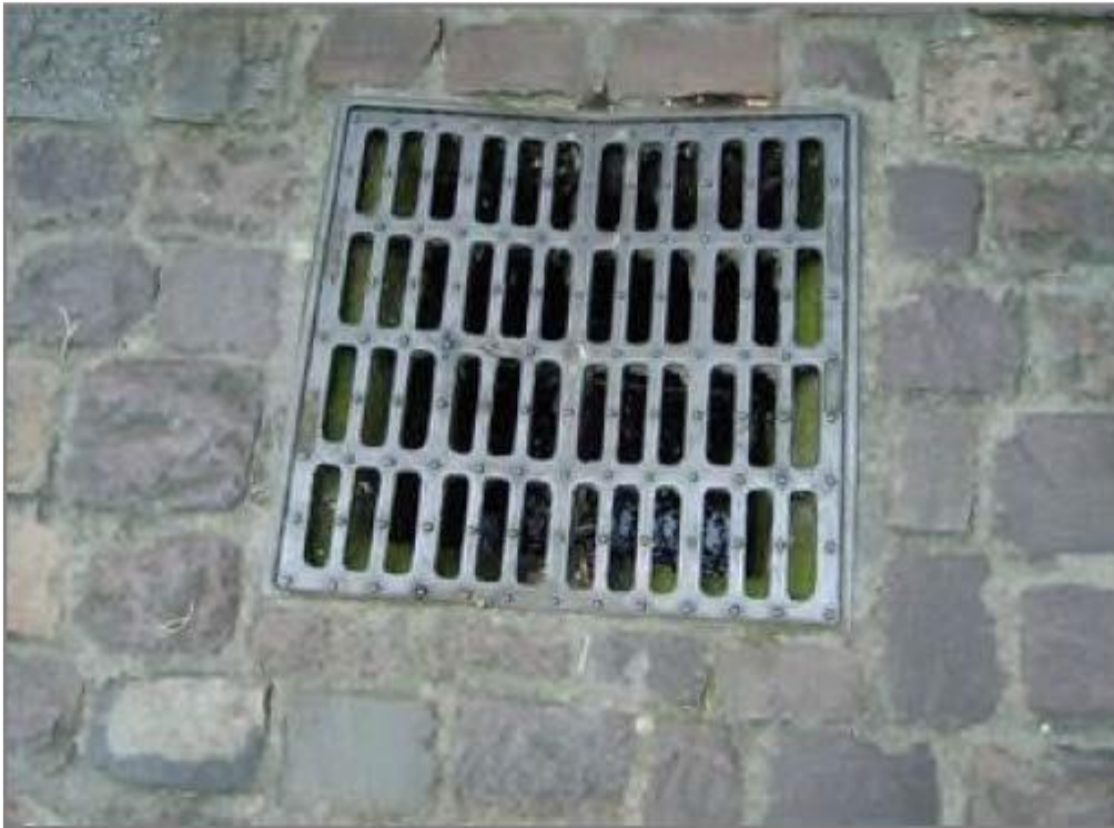
Bouche d'égout à grille
